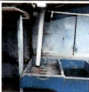
Foto 3: Bandeja de Agua fluvial y caja de registro.
